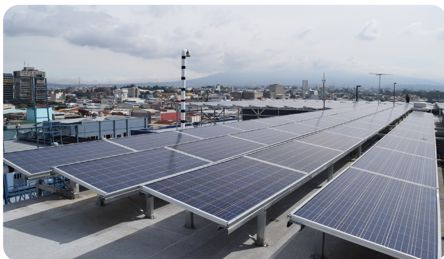
Figura 7. Paneles fotovoltaicos en el Hospital Clínica Bíblica en Costa Rica.
